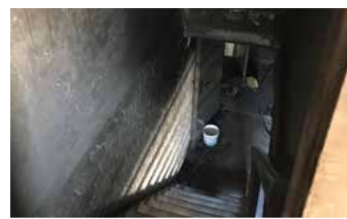
Kellertreppe nach dem Brand
